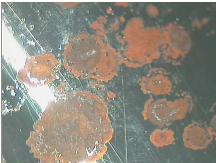
Abbildung 1: Mischgrundkörper: Messing/Nickel/Chrom-Beschichtung zerfressen und teilweise abgelöst bis aufs Grundmaterial. Hier wurde mit einem aggressiven Medium gearbeitet und schlecht mit Wasser nachgespült. Oberfläche auch mechanisch beschädigt, Kratzer deutlich sichtbar.
