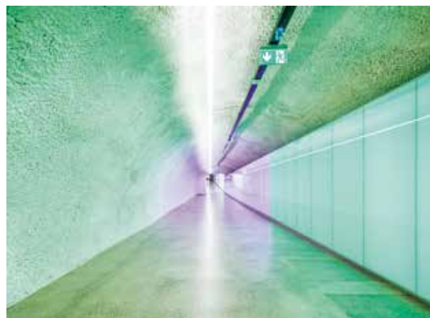
Die neu beschichtete Fussgängerpassage im Parkhaus «City Ost» in Thun ist eine der wichtigsten Durchgangsachsen zur Innenstadt.
